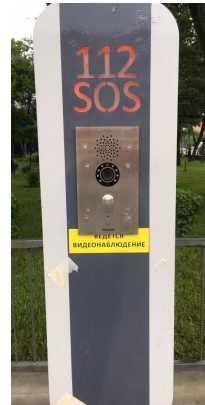
街角の所々に押しボタン式の緊急通報装置が設置されています。
